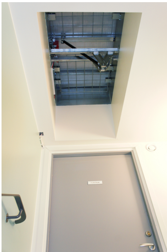
I taket syns en uppåtgående röklucka. Rökluckor används för att vädra ut brandrök. Se till att rökluckorna provas och servas regelbundet, förslagsvis årligen. Foto: MSB
