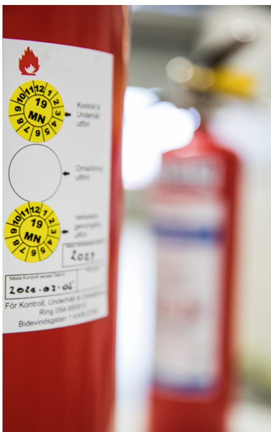
Visst underhåll av brandskyddet kan ordnas genom serviceavtal med en entreprenör. Foto: Pavel Koubek
