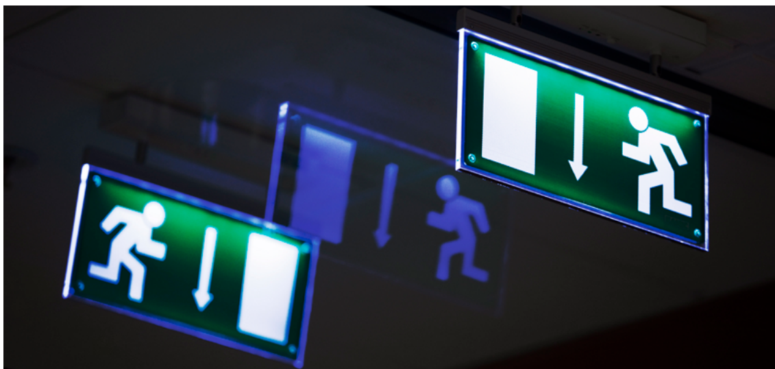
När det brinner får det inte uppstå tveksamheter kring var man kan ta sig ut. Svårorienterade utrymningsvägar i flerbostadshus ska vara markerade med utrymningsskyltar. Foto: Johan Eklund
